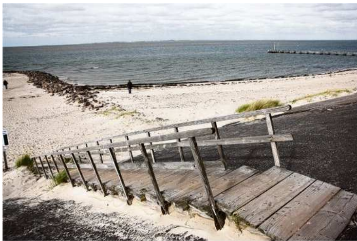
Die seeseitige Treppe am Deich bedarf ebenso einer Auffrischung wie die Gemeindekasse. Foto: psz
